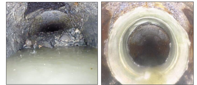
下水道管の破損状況
