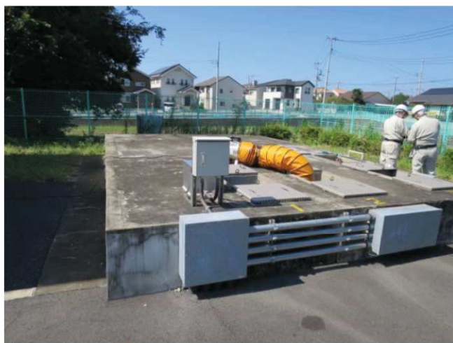
写真２－５ 日出谷污水中継ポンプ場（ポンプ井）
