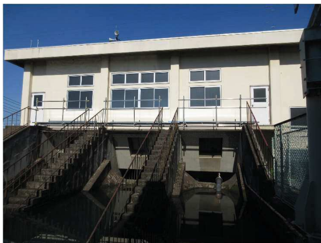
写真 2－2 芝川ポンプ場（雨水）
