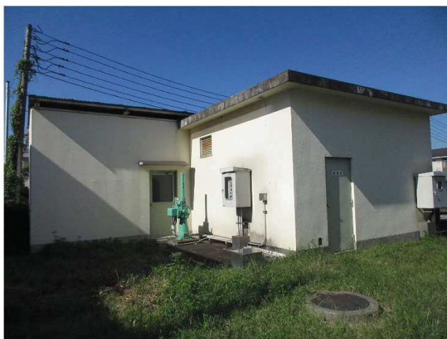
写真 2－1 芝川ポンプ場（汚水）
