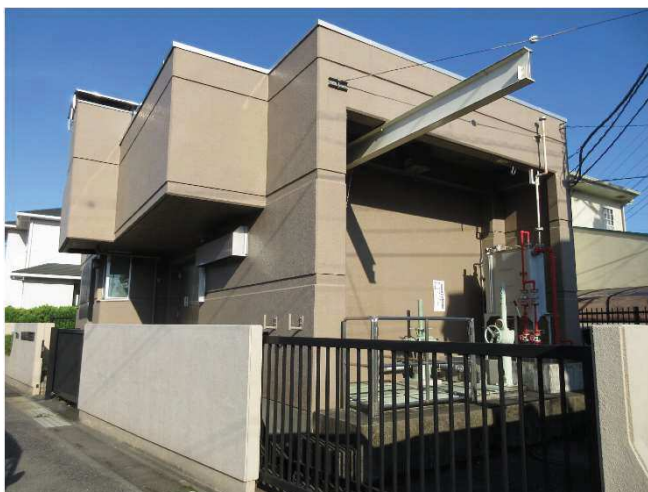
写真 2－3 朝日污水中継ポンプ場
