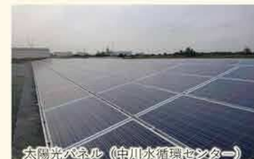
太陽光パネル（中川水循環センター）
