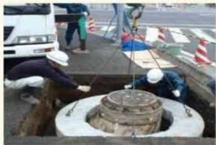
マンホールの耐震化
