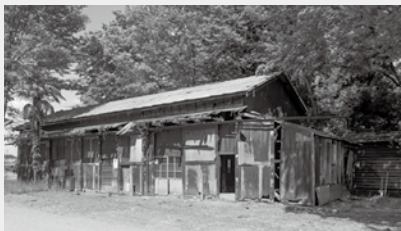
解体前の破損が著しい車庫棟外観写真
