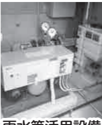
雨水等活用設備
