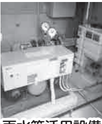
雨水等活用設備
