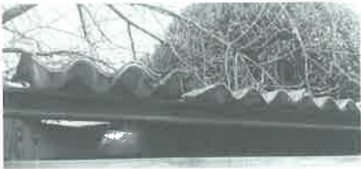
東中駐輪場スレート屋根の破損部分 (さくらフレンド隣接付近の箇所)
