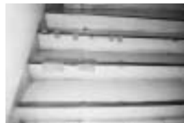
老朽化した階段
