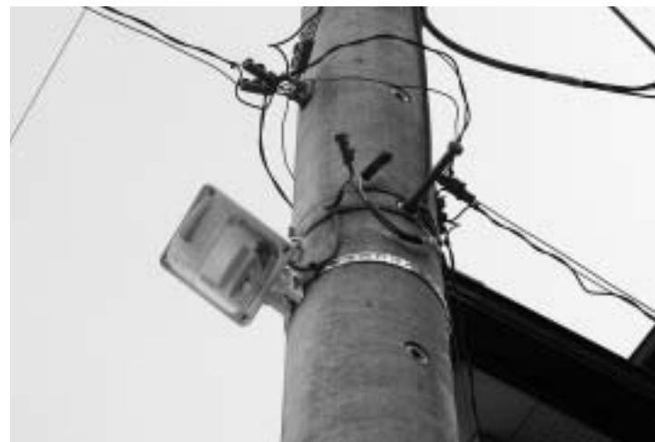
〈LED化された防犯灯〉
