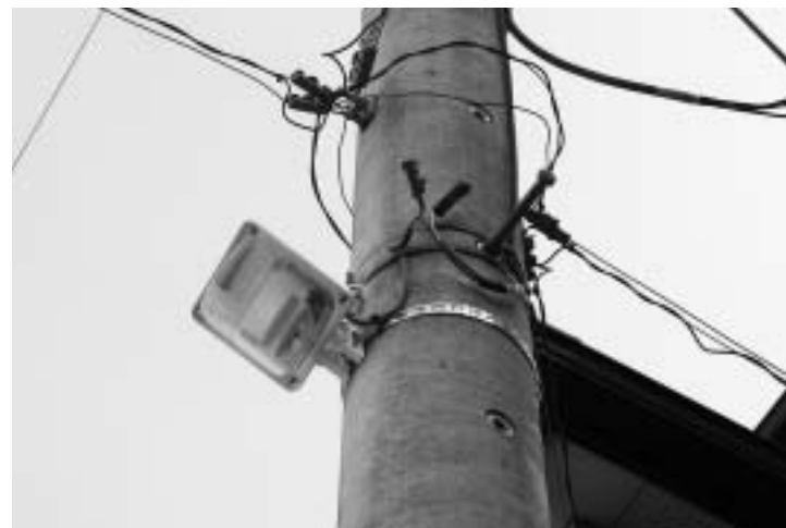
〈LED化された防犯灯〉
