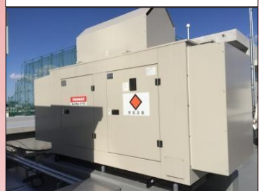
情報提供には欠かせない電 源確保「非常用発電機」
