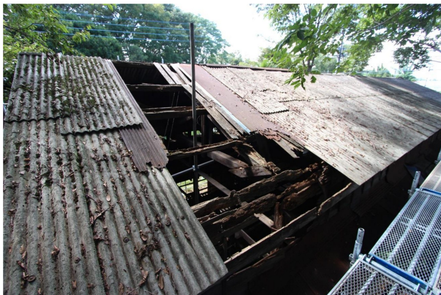
車庫棟 調査解体 屋根部分の腐朽状況
