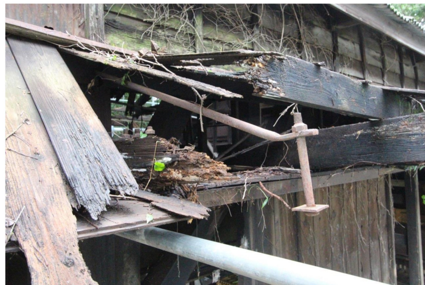
車庫棟 調査解体 大戸底部分の腐朽状況
