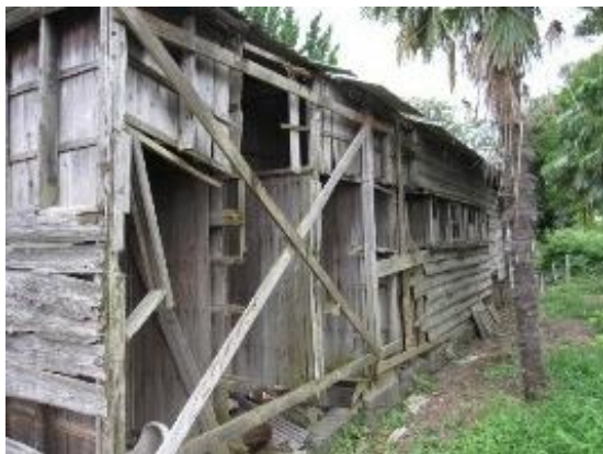
外壁破損状況
