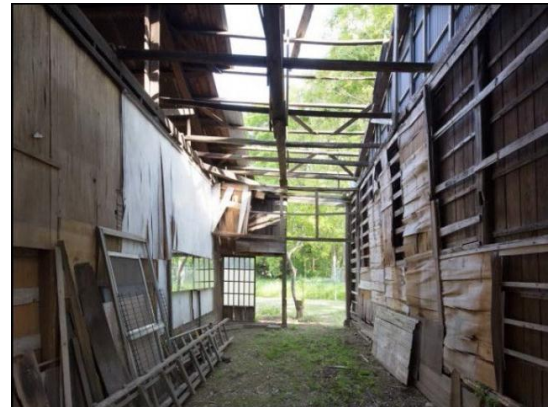
屋根及び外壁の著しい破損状況
