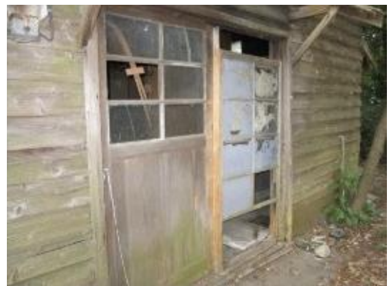
建具破損状況
