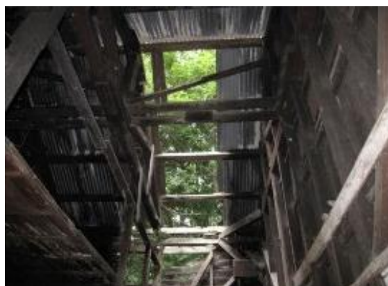
屋根破損状況
