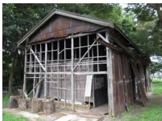
外壁破損状況
