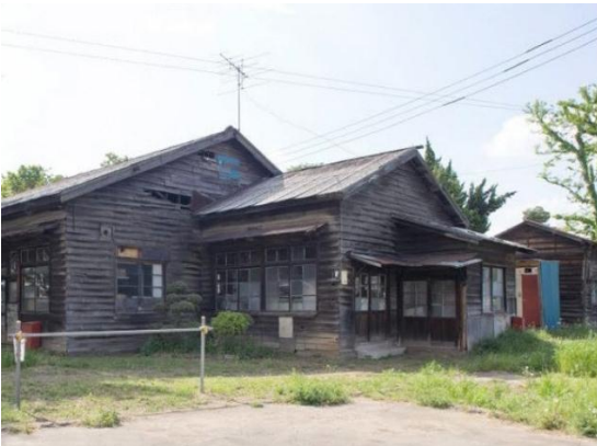
外壁などの破損状況
