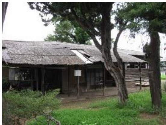
屋根破損状況
