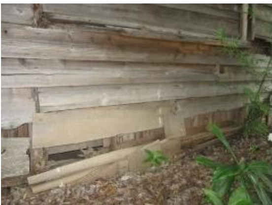
外壁破損状況
