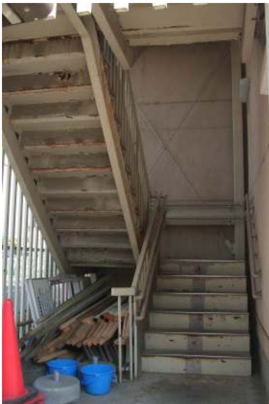
【腐食した外階段】
