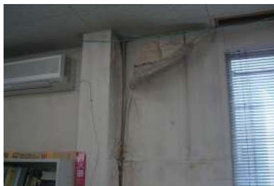
【雨漏りにより剥離した壁紙】
