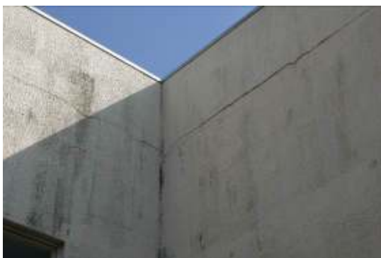
【外壁に生じた亀裂】
